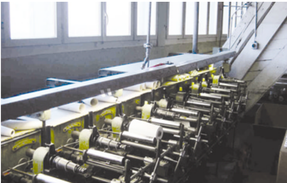
Nachrüsten ist bei der Wiederinbetriebnahme einer Occasionsmaschine Pflicht. Sie muss auf den aktuell gültigen technischen Stand gebracht werden, den die Sicherheit am Arbeitsplatz erfordert. (Bild: ZVG)
